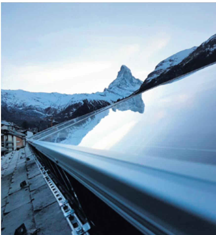
Een Solarus PowerCollector op het dak van een hotel in de Zwitserse Alpen.
