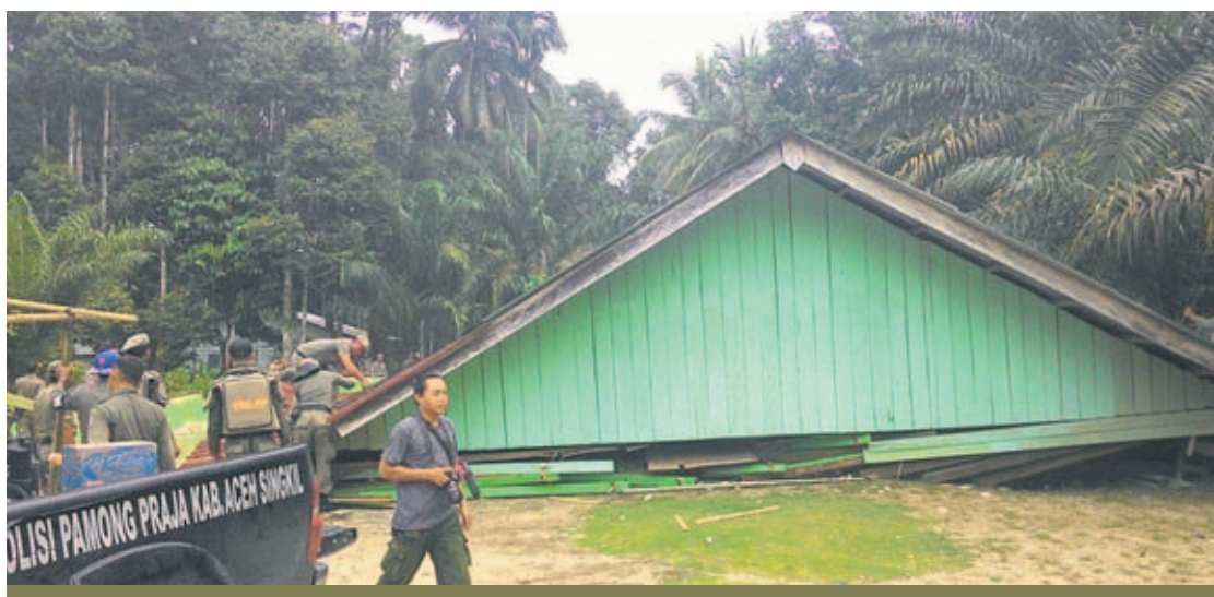
Politietroepen slopen een kerk in de provincie Atjeh. Als reden voor de sloop geven lokale bestuurders aan dat de bouwvergunningen niet zouden deugen.
